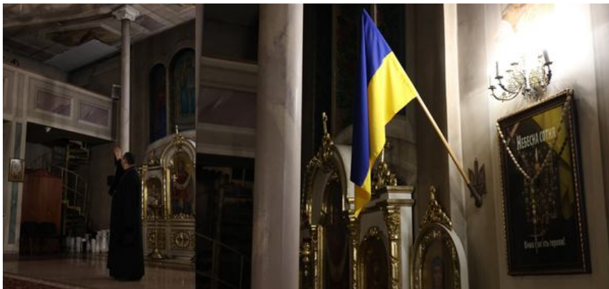
Отець Теодор показує пошкодження внаслідок російського ракетного обстрілу на стелі в храмі, де він служить. Фото авторки
